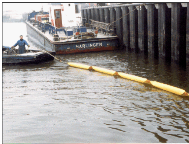
Figuur 14.10 Oliescherm langs een damwand om de olie te verzamelen die van de damwand wordt afgespoten met hogedrukspuiten
