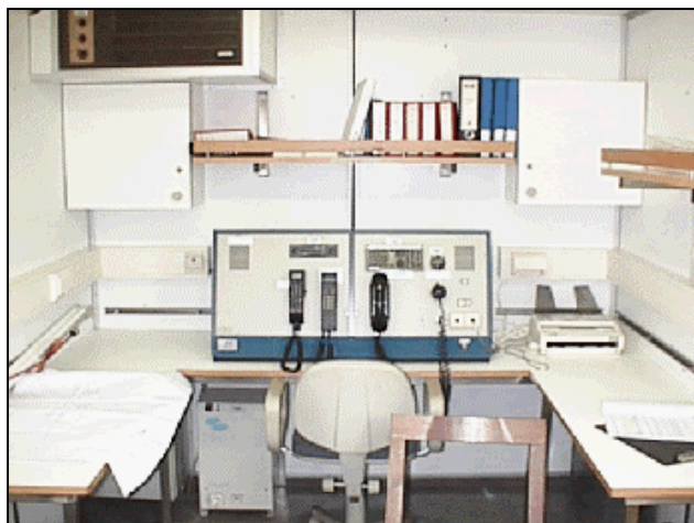
Figuur 2.7 Inrichting mobiele communicatie container van Rijkswaterstaat
